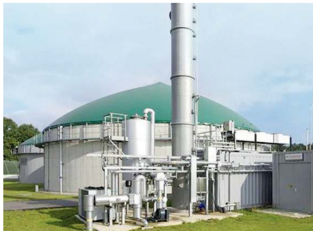
Biogas. L'impianto tratterà i rifiuti organici producendo compost e biogas, poi raffinato in biometano
